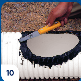
10 Sobre el adhesivo ya esparcido, aplique un cordón de adhesivo siguiendo el borde del orificio.
